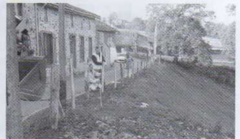
Vue des travaux du mur de Chélipeau (pose de la clôture par les employés communaux)
