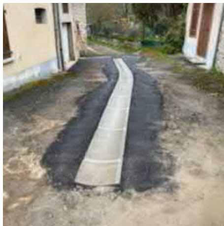
Canalisation des eaux à La Ribière
