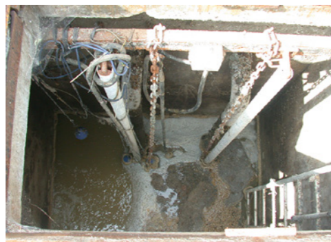
Poste de relèvement des eaux usées
