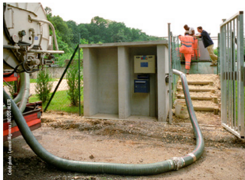
Extraction des boues produites à la station d'épuration
