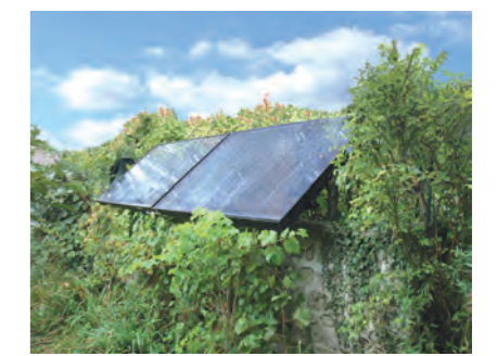
Les capteurs thermiques sont adossés à un mur du jardin. Cette solution demande une surveillance de la croissance de la végétation pour éviter toute ombre portée. Vigny (Val d'Oise) © PNR du Vexin français
