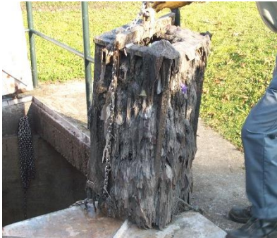
Photo : Obstruction d'un panier de dégrillage du réseau d'assainissement par des lingettes.
